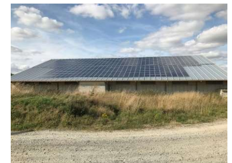
Production électrique photovoltaïque
